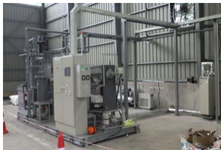
ベトナムに設置したフロン分解炉
